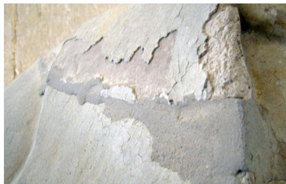
Fig. 78 - Escultura do Papa Gregório. Rede de estalados com destacamentos junto às argamassa de cimento.
