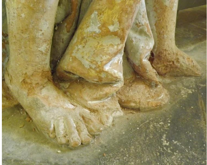
Fig. 65 - Tacelo inferior do Anjo 1. destacamentos de lascas da terracota.
