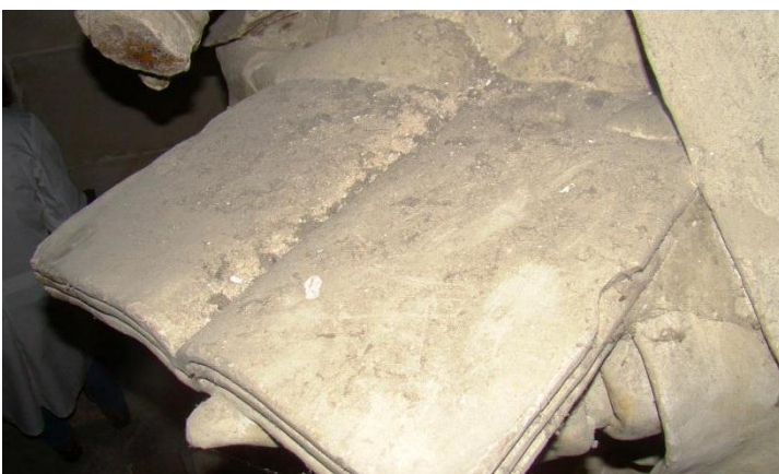
Fig. 83 - Acumulação de pó na superfície.
