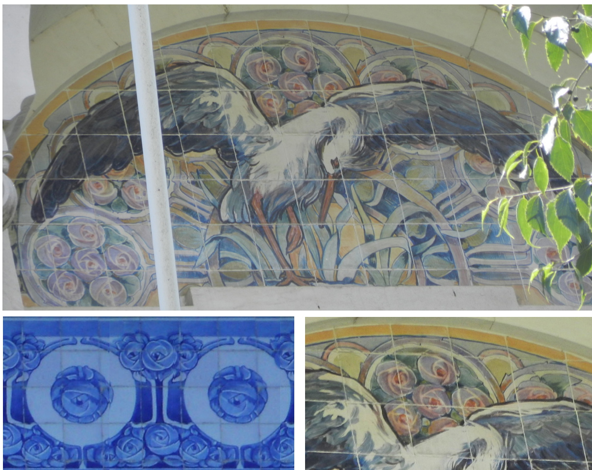
Fig. 198 - Painel com cegonha ocupando o semi-círculo sobre a janela do quinto piso. O dimensionamento corresponde exactamente ao local de aplicação, pelo que se trata de azulejos especificamente executados para o edifício.
