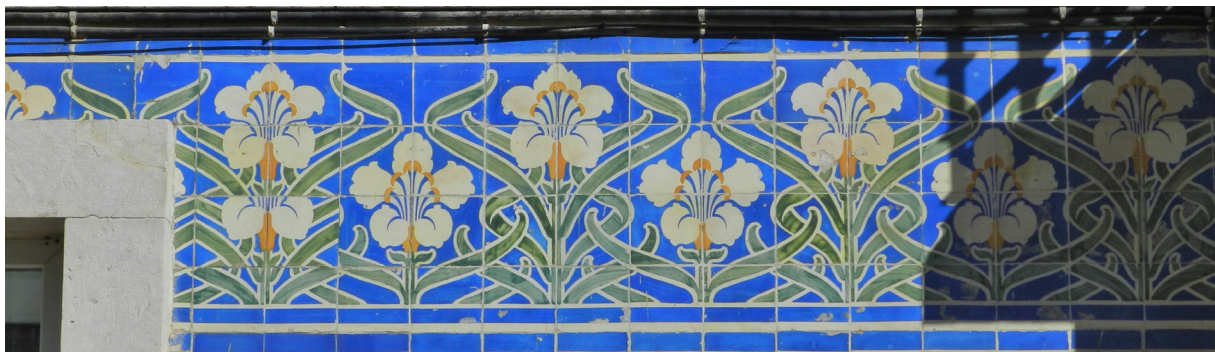
Fig. 189 - Casa do Comendador Emilio Liguori e Casa de Joaquim dos Santos Lima - Padrão inicialmente utilizado no remate do edifício e na separação entre o piso térreo e o segundo piso.
