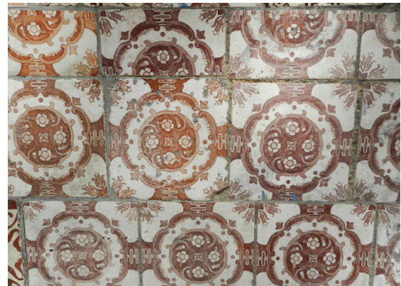
Fig. 264 - Assentamento deficiente. Rua Almirante Barroso nº 14.
