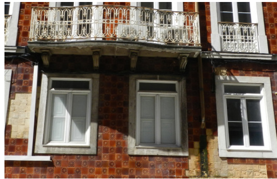
Fig. 258 - Lacunas - ausência de azulejos. Rua Andaluz nº 38.
