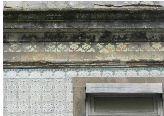
Fig. 267 - Manchas e depósitos superficiais. Rua D. Estefânia nº 129.
