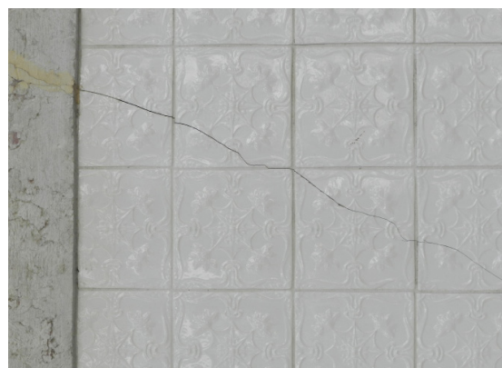
Fig. 263 - Fractura. Rua Alexandre Herculano nº 39.
