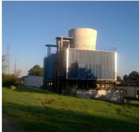
Figura 7 - Sistema de refrigeração da Lusosider
