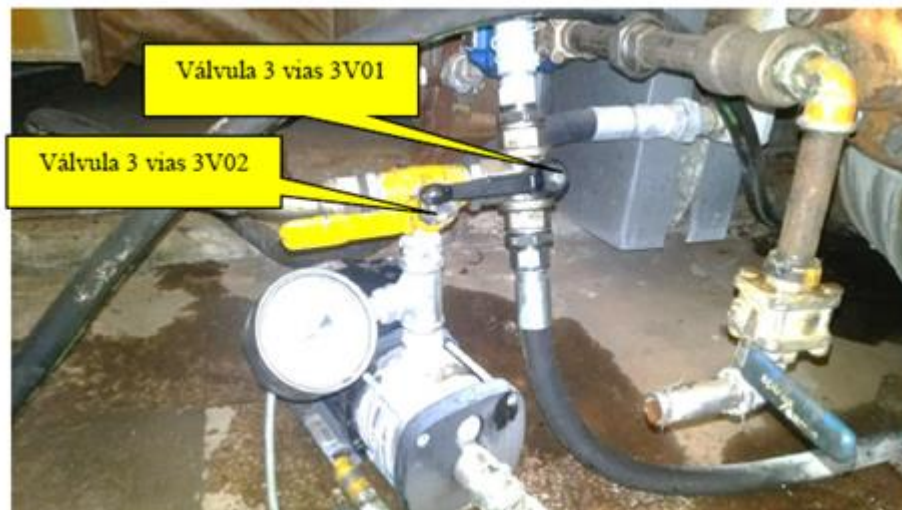
Figura 10 - Bomba de água quente e válvulas de 3 vias
