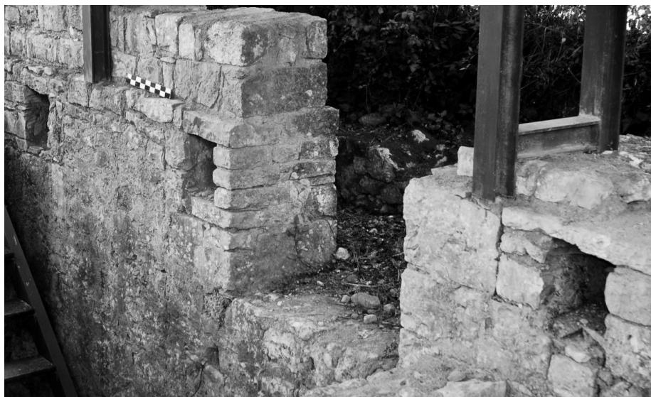
Figura 97 – Vestígios de dispositivos de soalhos de madeira na casa dos Repuxos: encastramento de traves no corredor nº 4. (A abertura da porta não é contemporânea).
