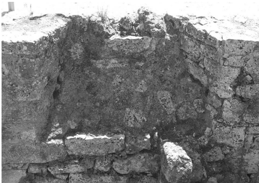
Figura 77 – Pormenor de uma janela em boca de lobo do criptopórtico das lojas a sul da via.
