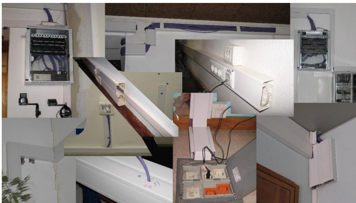
Figura 3.1 - Aspeto de várias áreas onde a instalação dos passivos foi efetuada de forma deficiente
