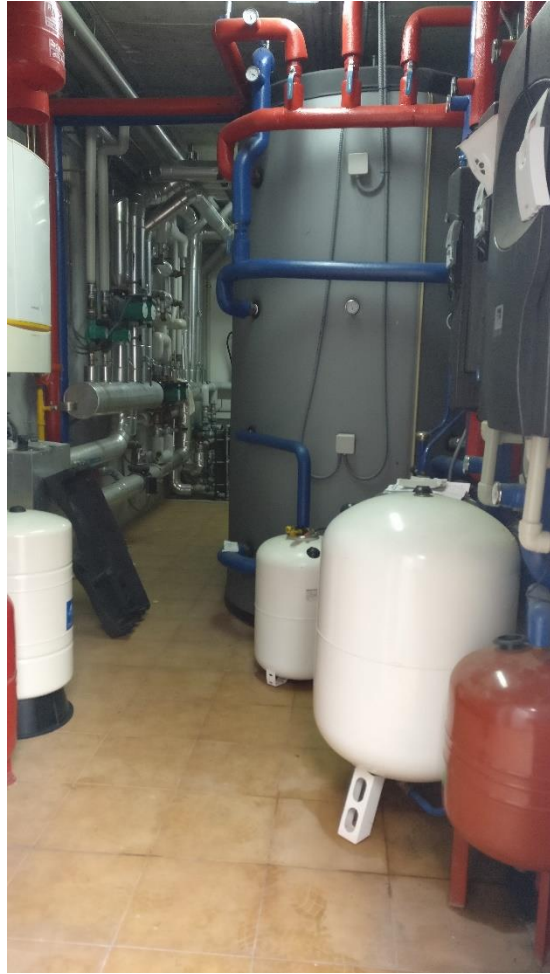
Fig. 217: Sala técnica con depósito de inercia.
