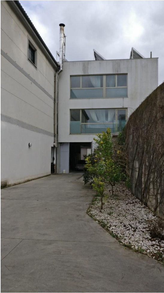
Fig. 216: Salida de humos de la caldera.
