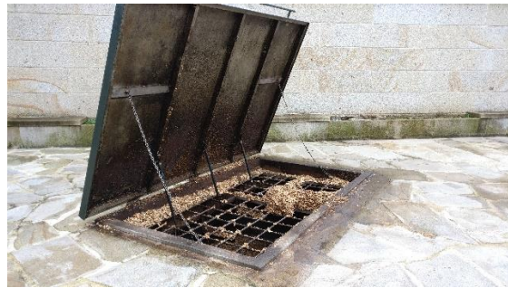
Fig. 197: Rejilla de protección para descarga de la astilla.
