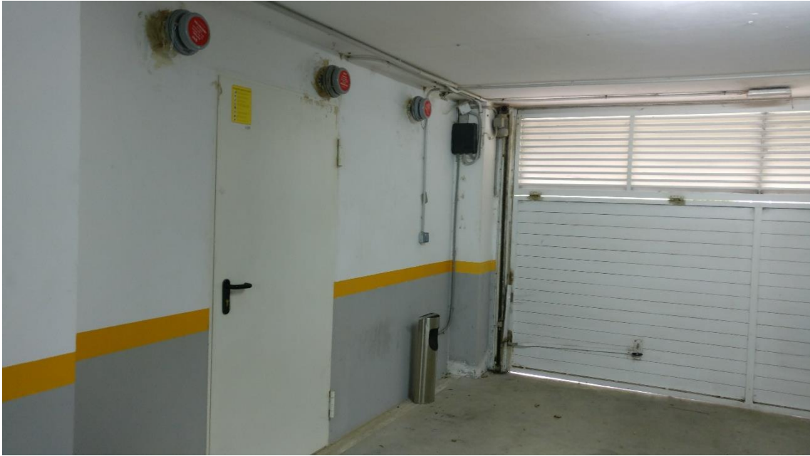
Fig. 222: Bocas de descarga del combustible.
