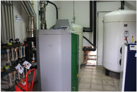
Fig. 185: Sala de calderas.
