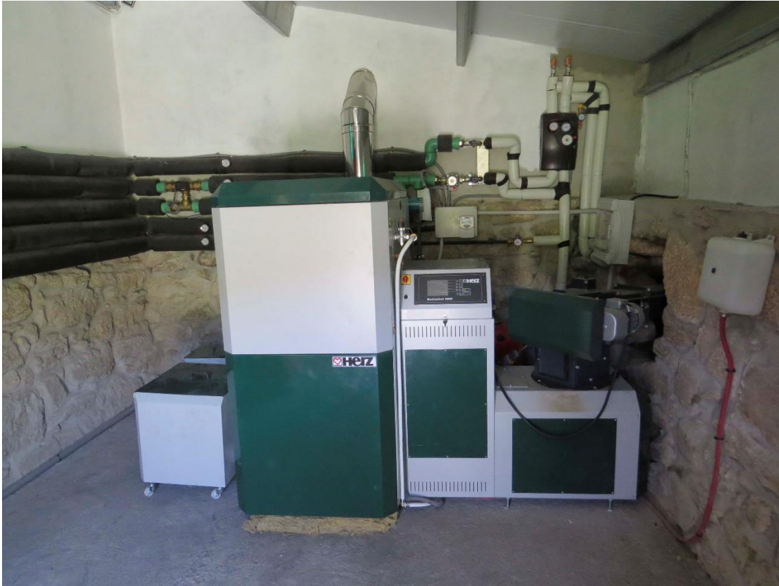
Fig. 228: Interior de la sala de calderas.
