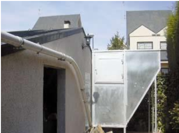
Fig. 38: TOLVA EXTERIOR CON ALIMENTACIÓN MEDIANTE TORNILLO SINFIN.
