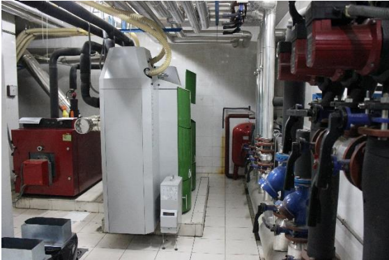
Fig. 190: Calderas utilizadas en la instalación.
