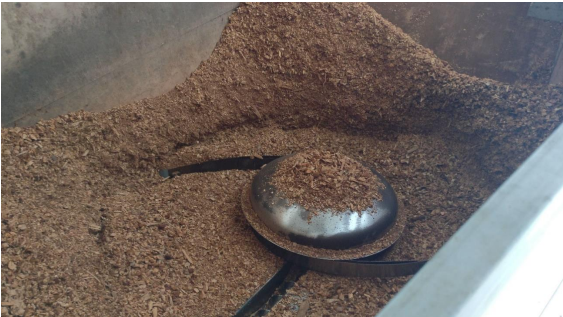
Fig. 218: Agitador de astilla, que conduce el combustible al tornillo sinfín.
