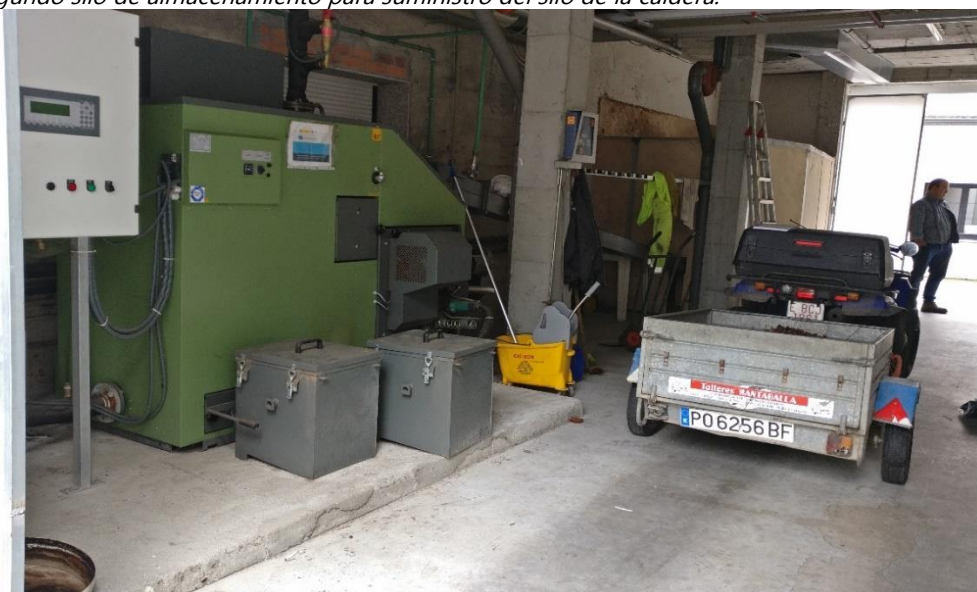
Fig. 215: Sala de caldera y silo de obra con alimentación a través de tornillo sinfín.
