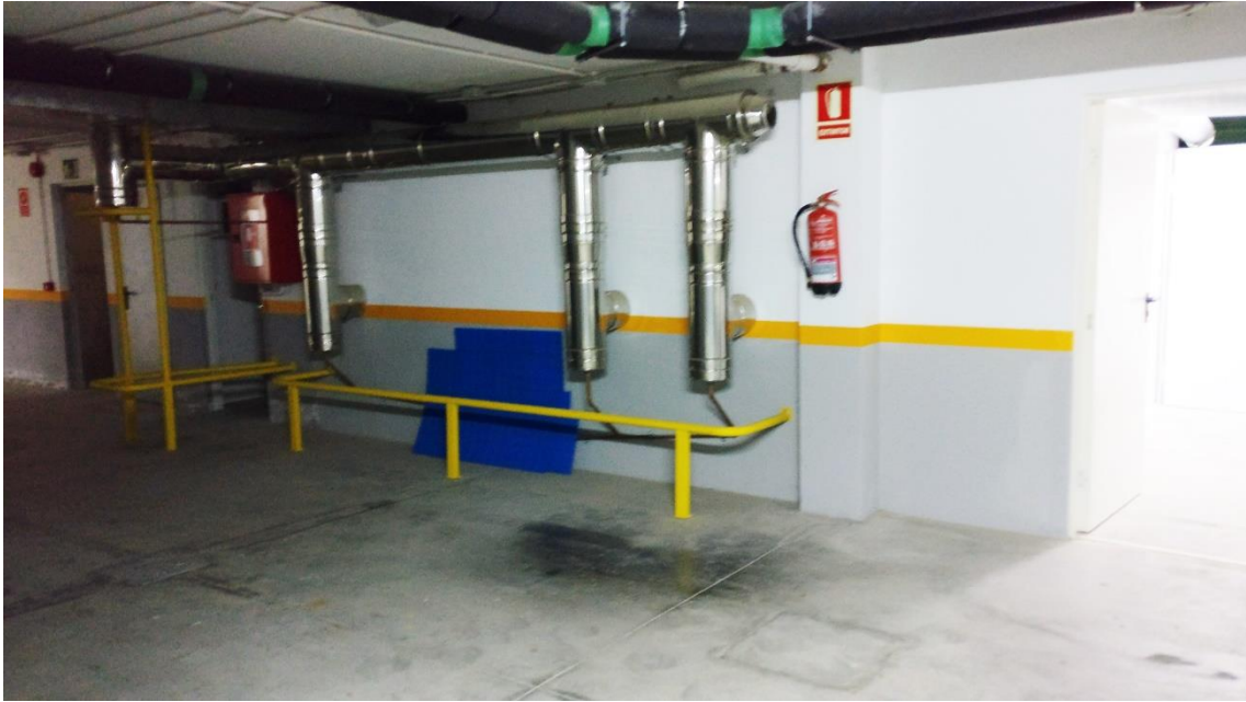
Fig. 224: Salida de humos en el sótano -1.
