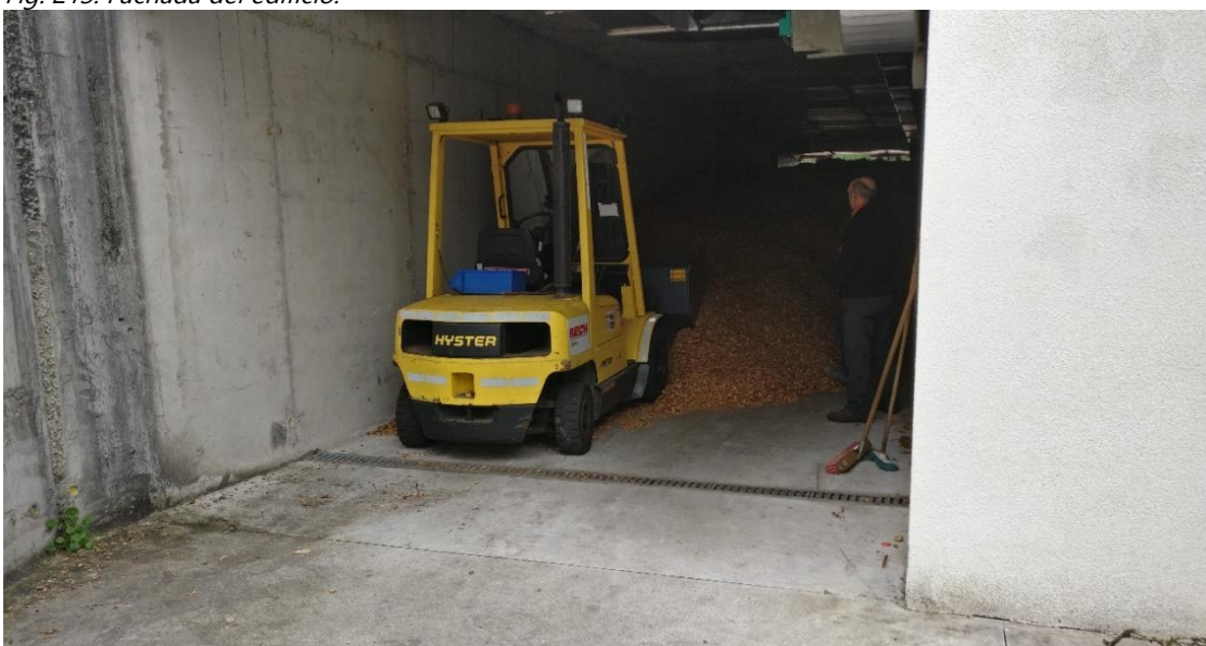
Fig. 214: Segundo silo de almacenamiento para suministro del silo de la caldera.
