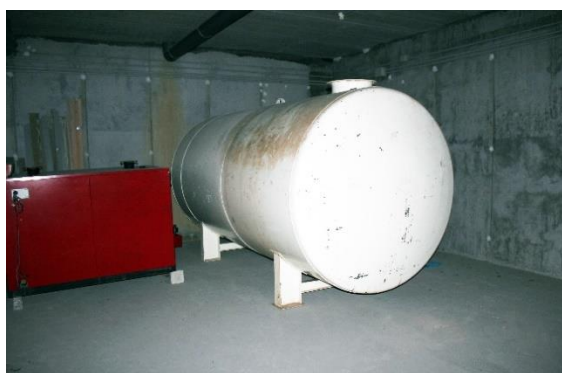
Fig. 195: Tanque de gasóleo y antigua caldera.
