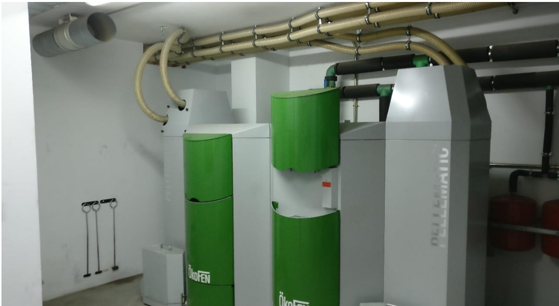
Fig. 219: Sala de calderas del Hotel Via Argentum.
