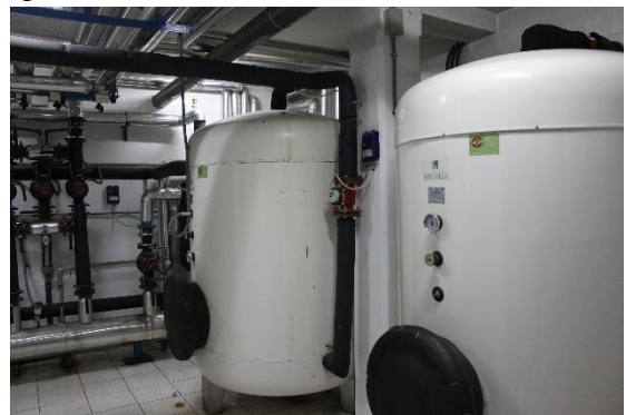
Fig. 191: Deposito de inercia y ACS de 2350 cada uno.
