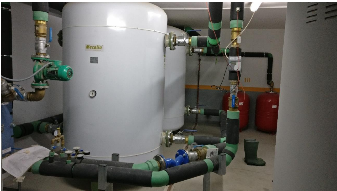
Fig. 223: Depósitos de inercia de 2000L cada uno.
