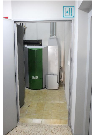
Fig. 179: Sala de calderas.
