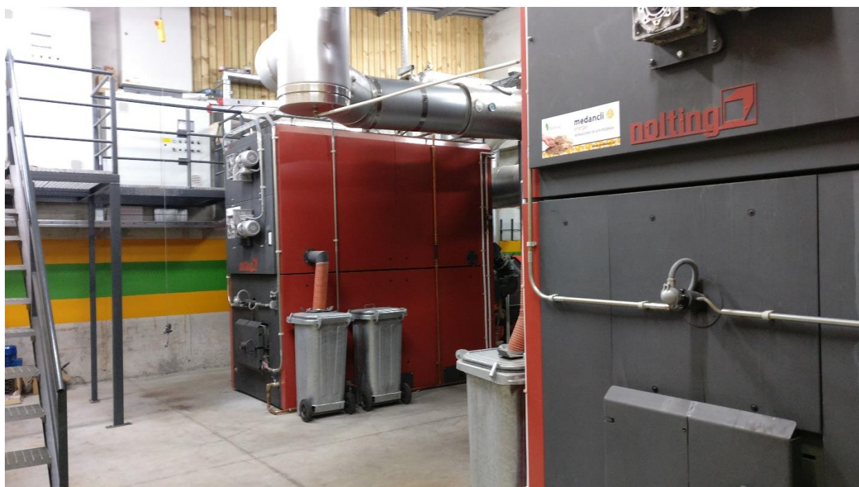
Fig. 113: Instalación de biomasa para los tres edificios del Balneario.
