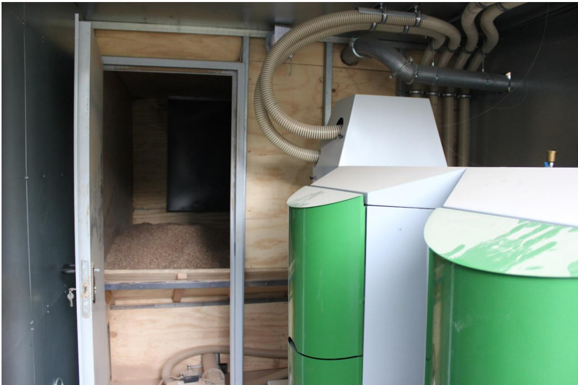
Fig. 232: Sala de calderas y silo de almacenamiento en el contenedor marítimo.
