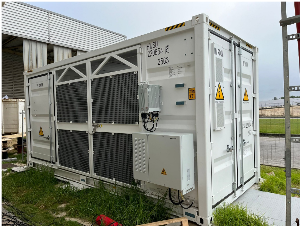
Figura 4.18: Contentor onde está o QGPV e o Transformador
