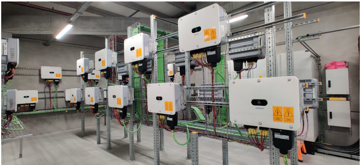
Figura 4.13: Vista geral dos inversores na sala técnica - parte 2.
