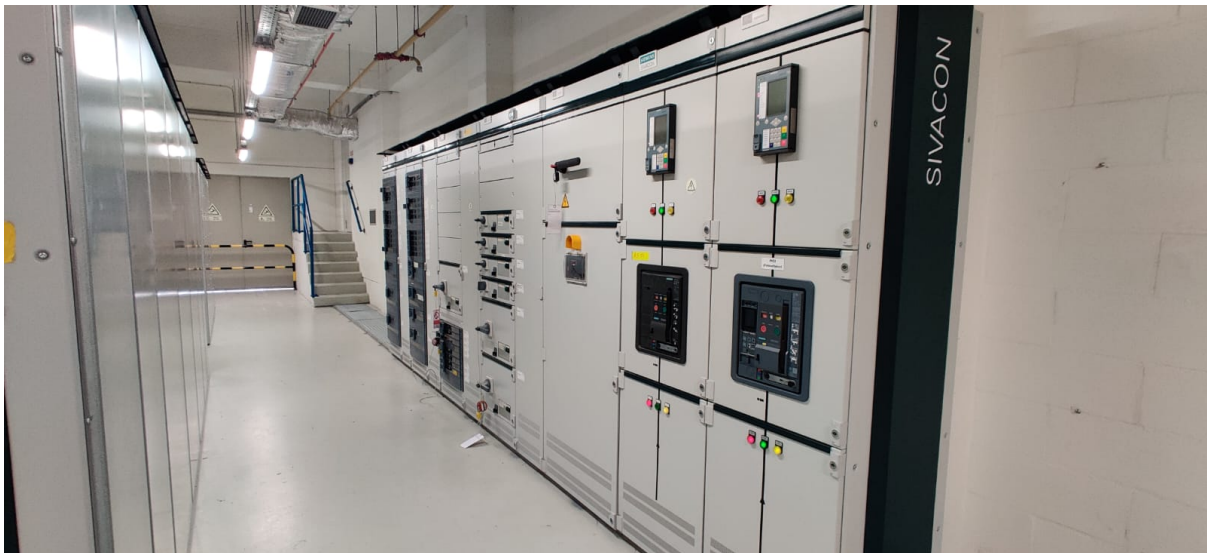
Figura 4.15: Cella do MCC onde liga o QGPV.
