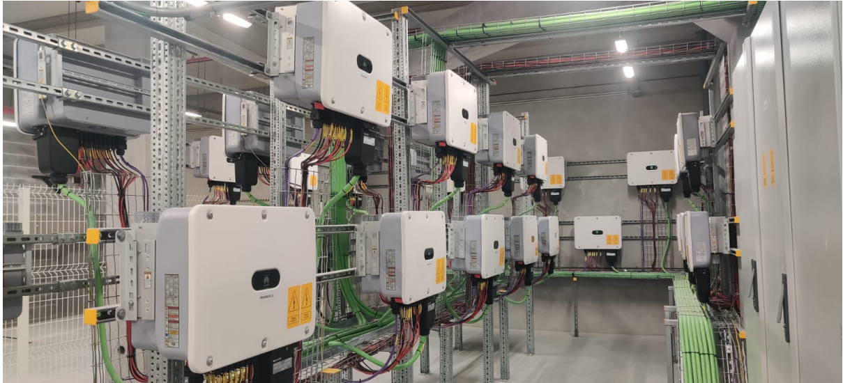
Figura 4.12: Vista geral dos inversores na sala técnica - parte 1.
