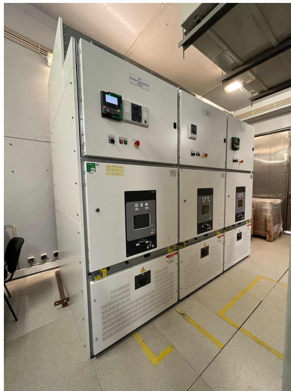
Figura 4.21: Celas 15 kV onde liga a PV Station da Central do solo - Sala da Cogeração.
