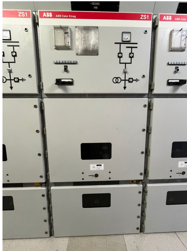
Figura 4.20: Cella de interligação 15 kV na sala da cogeração.
