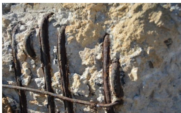
Fig. 43 - Corrosão das armaduras (elaborada pelo autor)
