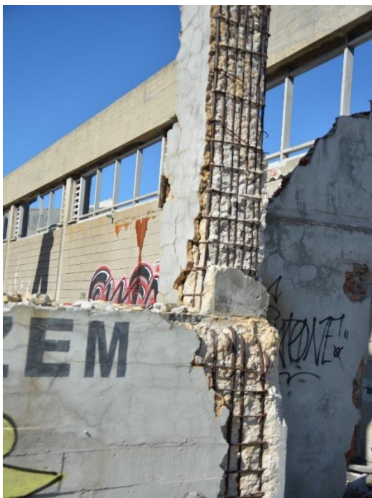
Fig. 40 - Estrutura degradada (elaborada pelo autor)
