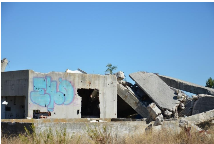
Fig. 39 - Estrutura danificada devido a desmantelamento (elaborada pelo autor)
