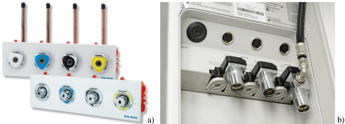
Figura 47 – Rampas de gases num bloco operatório e conector norma NIST, a) e b) respetivamente [53].
