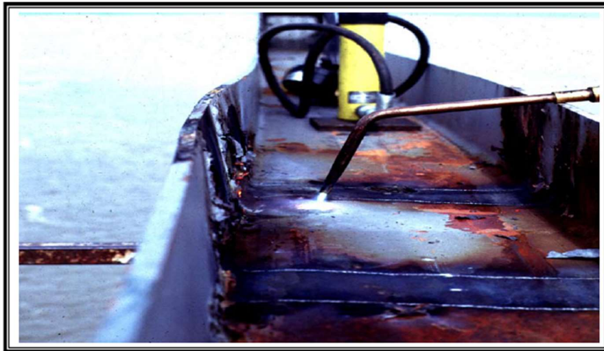
Figura 58 Execução de aquecimento por faixas, com uma faixa completa em primeiro plano (FHWA, 2008)
