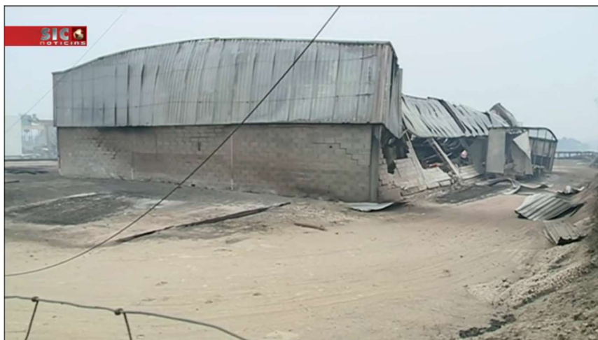
Figura 17 Instalações de empresas na Zona Industrial de Oliveira de Frades, atingidas pelos IF em outubro de 2017 (Sic Notícias)
