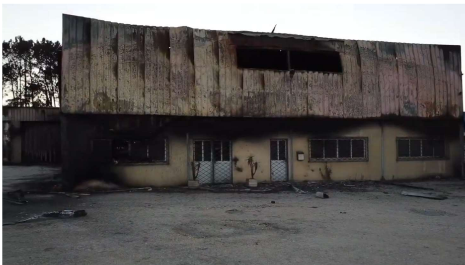
Figura 13 Instalação na Zona Industrial de Mira, atingida pelo IF em outubro de 2017 (Sic Notícias)
