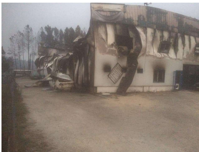
Figura 5 Perspetiva frontal das Instalações da empresa AP Pais, em Seia, atingidas pelo IF de outubro de 2017 (página de facebook da empresa)
