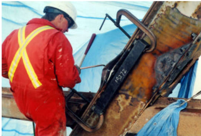
Figura 4 Execução de endireitamento térmico no elemento estrutural deformado de uma ponte (Alberta Transportation, 2004)
