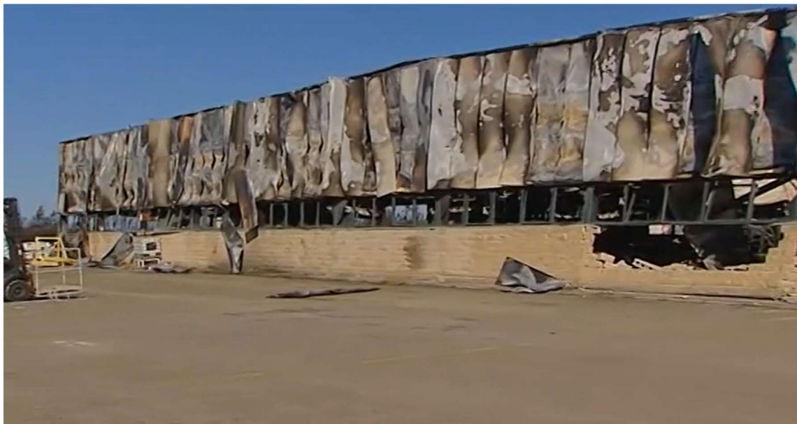
Figura 2 Instalações da empresa Sanindusa 2, na Zona Industrial da Tocha, atingidas pelo IF em junho de 2017 (Sic Notícias)
