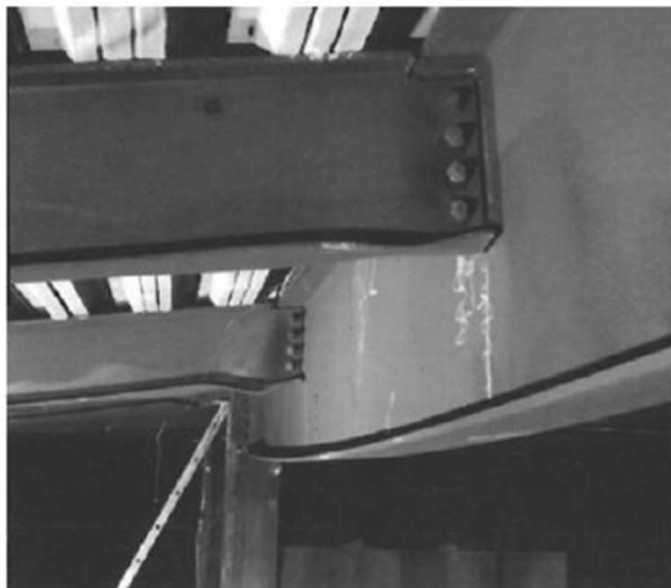
Figura 34 Deformações localizadas devido à rigidez axial das ligações adjacentes (Maraveas, C. et al, 2015)
