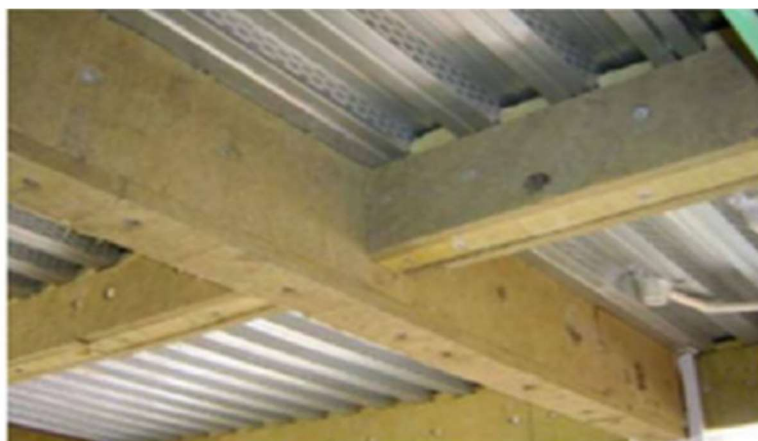
Figura 27 Proteção de elementos metálicos com placas de lã de rocha (Soares, E., 2014)
