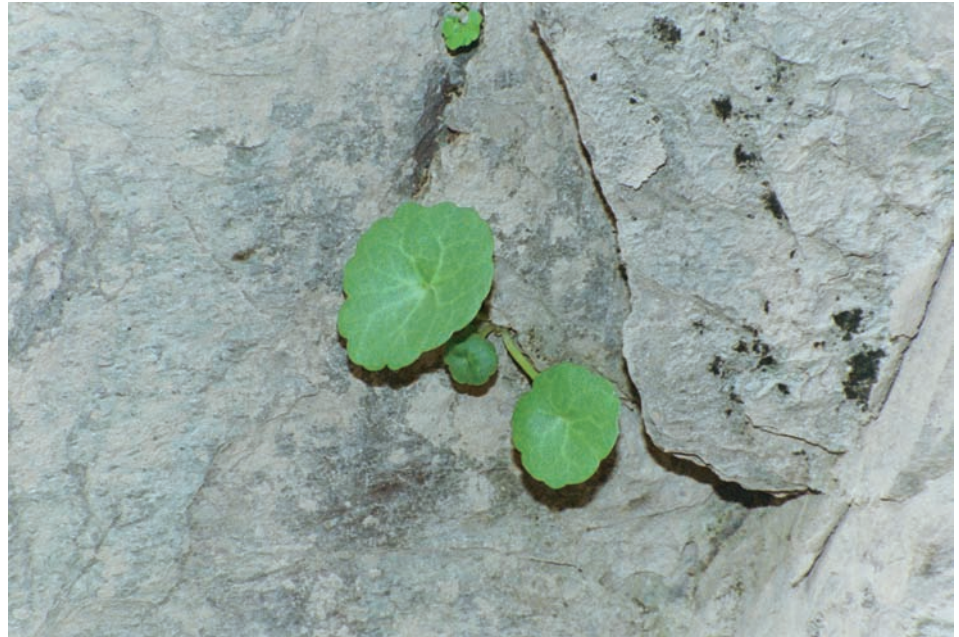
fig. 16 Planta superior desenvolvendo-se a partir de uma fissura.
