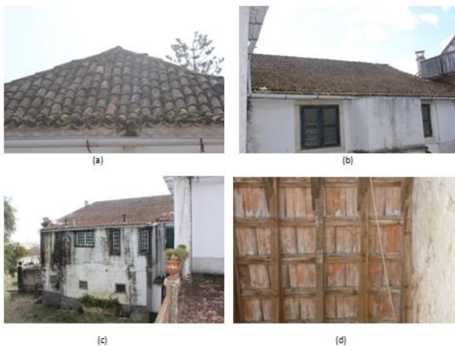
(a) (b) e (c) e (d) As fotos ilustram a cobertura inclinada, em que são visíveis telhas partidas, deslocadas e descascadas
