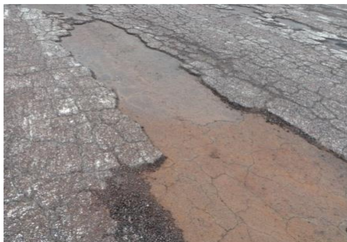
Figura 13. Erosão do pavimento da pista. Fonte AACGB, (2019).
