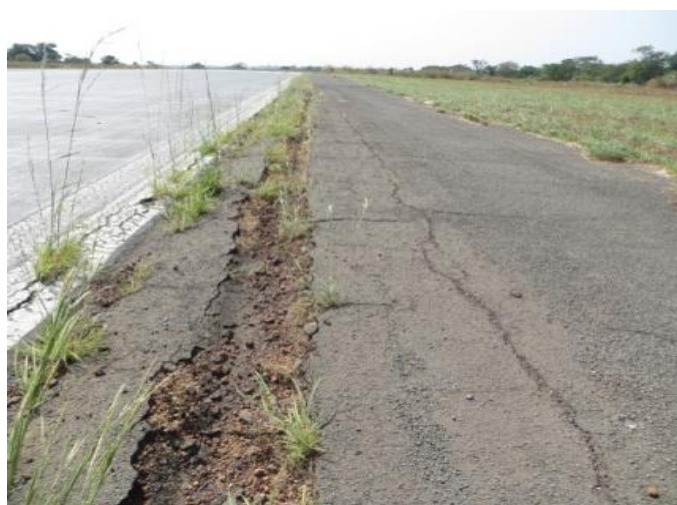
Figura 14. Erosão do pavimento da berma da pista. Fonte AACGB, (2020).
