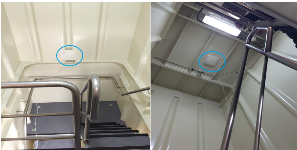
Figura 40- As duas posições da antena no tronco de escadas
