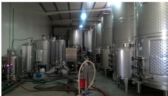
Figura 7 - Área de produção, onde se encontra o filtro tangencial e o pasteurizador, e o início da linha de enchimento.
