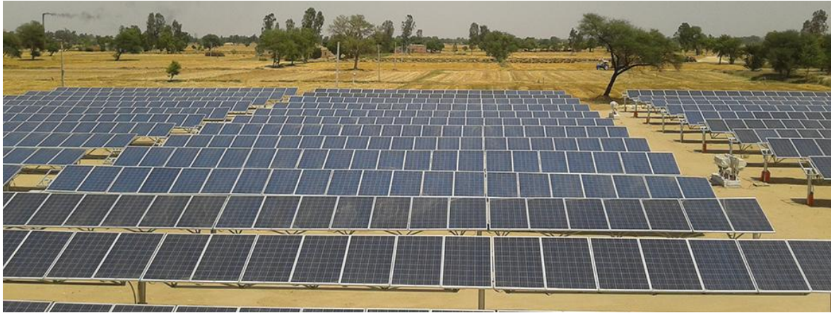
Figura 19: Fotografia do sistema fotovoltaico instalado pelo Grupo SINERGIAE na Índia, fonte: [34]
