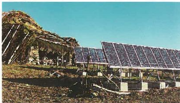
Gerador fotovoltaico de 800 Watt pico na Serra da Estrela.
