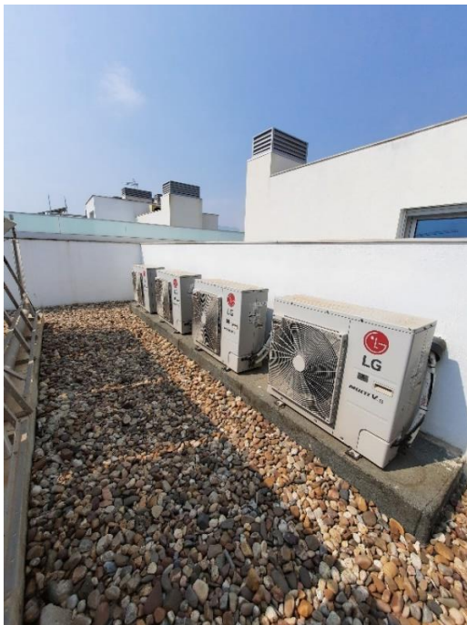
Figura 22: Unidade Exterior VRF no Terraço
