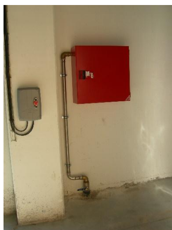
Figura 8 - Rede de Incêndio Armada.
