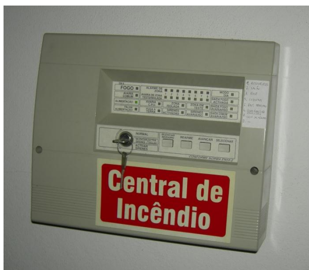
Figura 10 - Central de Incêndio
