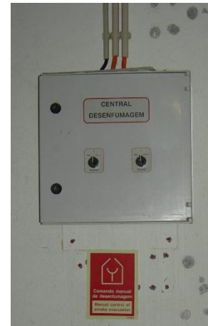
Figura 12 - Central de Desenfumagem
