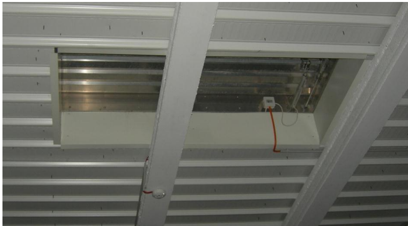
Figura 11 - Ventilador de Cobertura.
