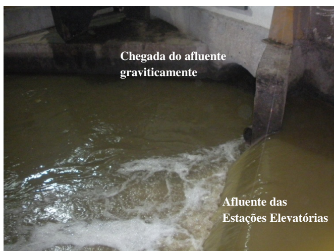
Figura 9: Afluente à ETAR de Chelas com origens distintas, proveniente do coletor gravítico e das estações elevatórias.
