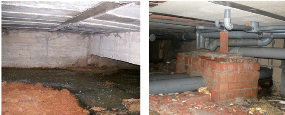
Fig. 74 y 75 - Fotografías del espacio existente bajo el forjado sanitario de una construcción local. Fuente: Fotografía del autor.
