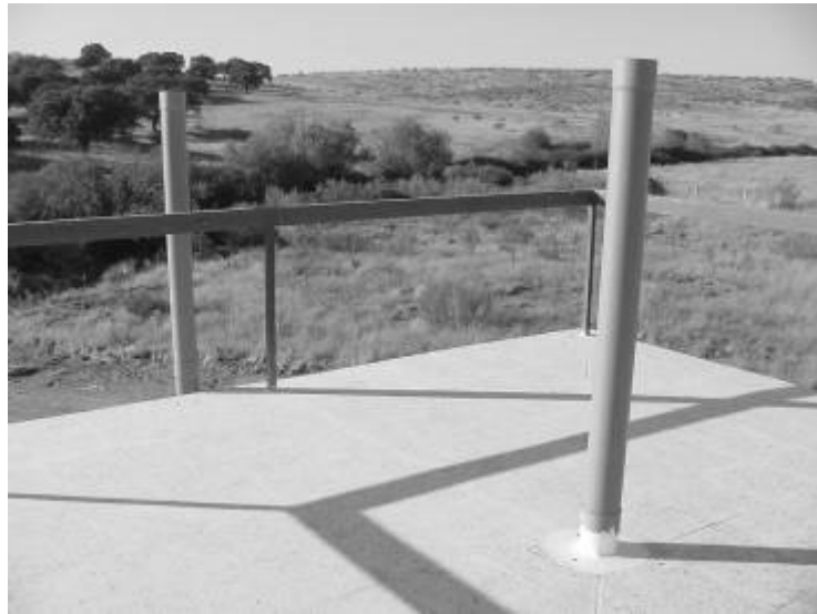
Figura 14. Salida de los tubos a cubierta. En esta fotografía se encuentran sellados en su extremo.
