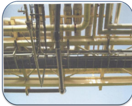
Figura 5: Tubagens aéreas na Autoeuropa.
