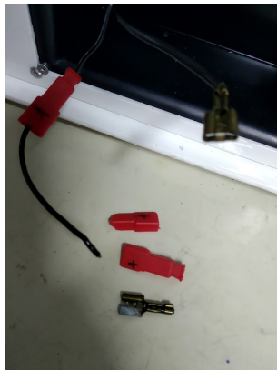
(a) Terminais da bateria do Ventilador partidos.
