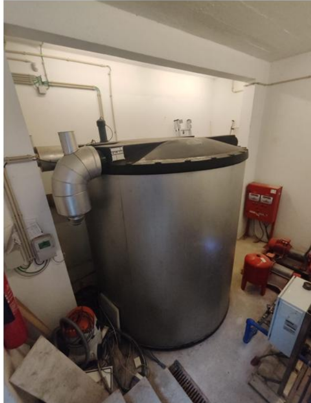
Figura 57 – Banco de Gelo CALMAC 1190
