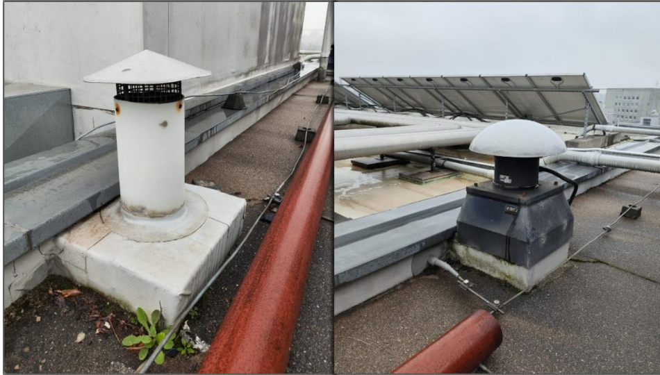
Figura 36 – Exemplos de ventiladores de extração, no INESC A
