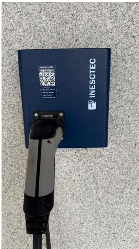
Figura 70 – Exemplar de posto de carregamento na fachada Norte do INESC B
