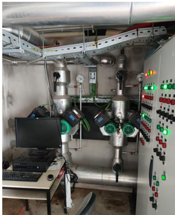
Figura 59 – Grupos de bombagem do circuito de arrefecimento da UTAN (dir.) e do circuito de arrefecimento dos VC's (esq.) – Wilo CronoBloc-BL 32/160-0,55/4 e Typ DP E40/130-2,2/2
