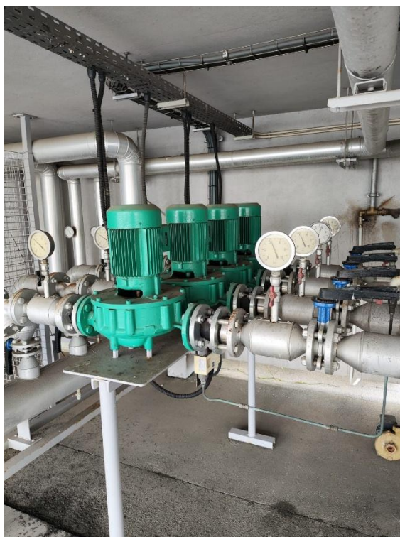
Figura 26 – Grupos de bombagem de água aquecida – Wilo IPn40/250-1,5/4
