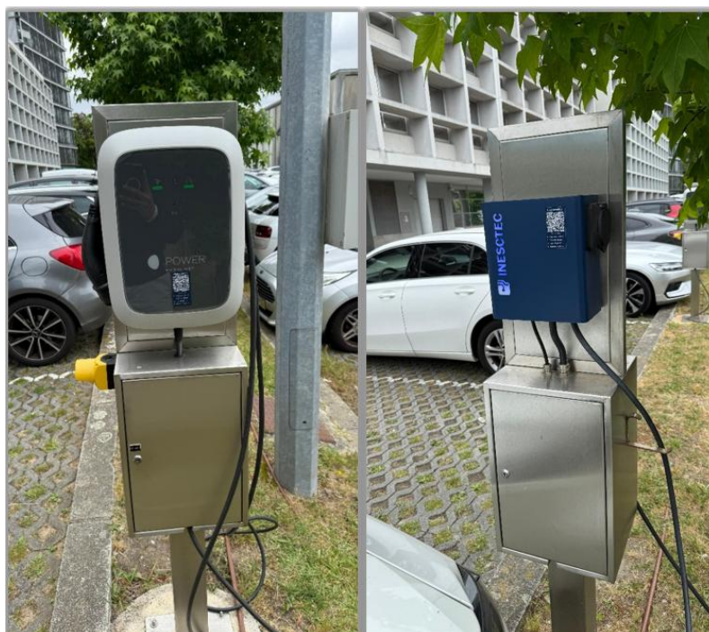
Figura 44 – Exemplos de postos de carregamento na Fachada Sul do INESC TEC
