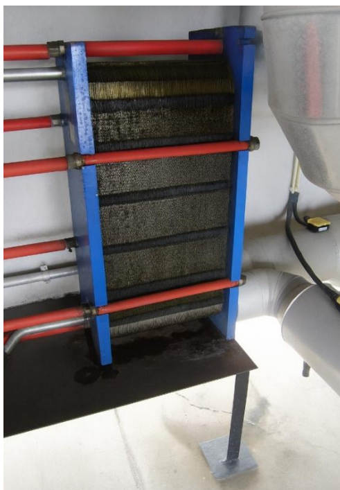
Figura 30 – Permutador de calor ALFA LAVAL M6-FG
