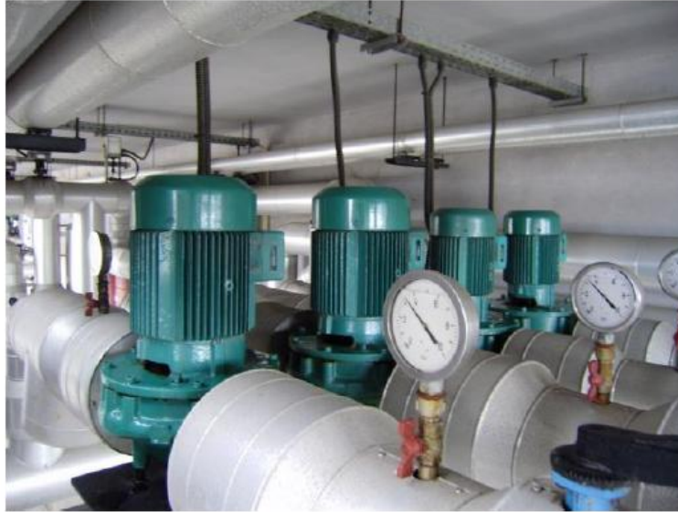
Figura 32 – Grupos de bombagem de água refrigerada (secundário) – Wilo IPn65/250-4/4 e IPn40/250-1,5/4
