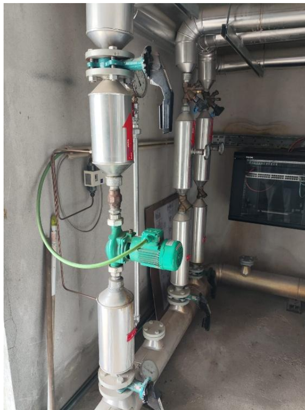
Figura 53 – Bomba circuladora do circuito primário da caldeira – Wilo Typ IPL25/80-0,12/2
