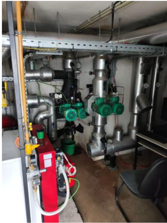
Figura 58 – Grupos de bombagem do circuito primário Chiller -Permutador de Calor (esq.) e do circuito secundário Chiller -Permutador de Calor (dir.) – Wilo CronoLine-IL 32/170-4/2 e Stratos PICO 25/1-6
