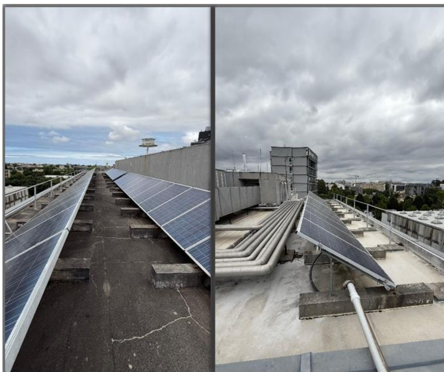
Figura 48 – Instalação solar fotovoltaica no INESC TEC
