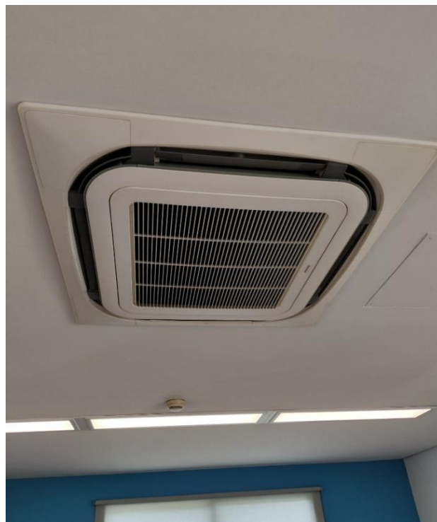
Figura 35 – Unidade Multi-Split , existente na sala A3.7
