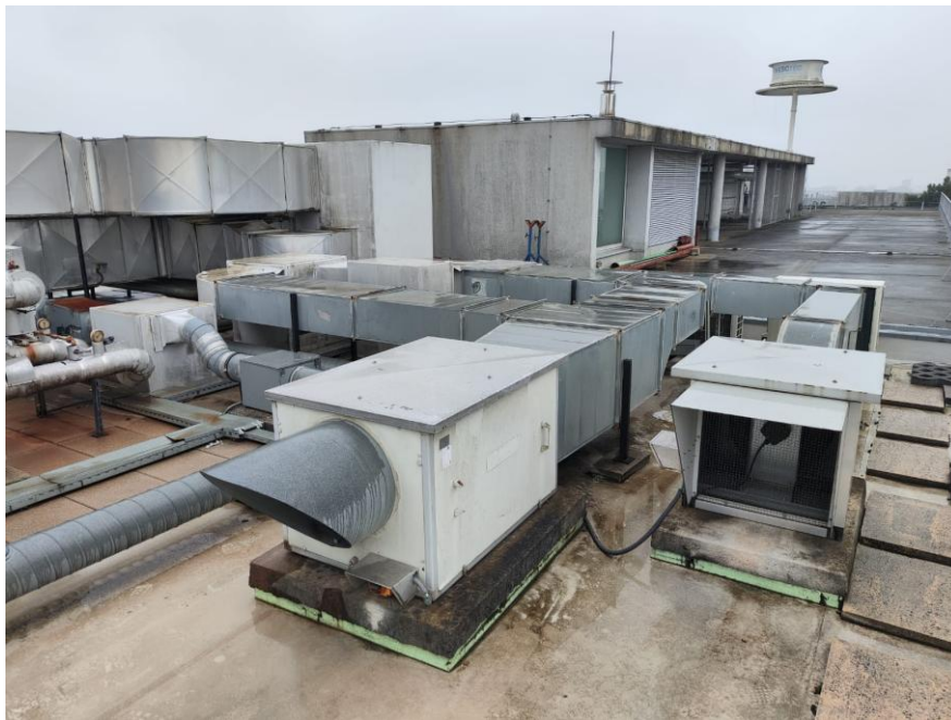
Figura 63 – Visão geral sobre os ventiladores de extração e de insuflação, do INESC B
