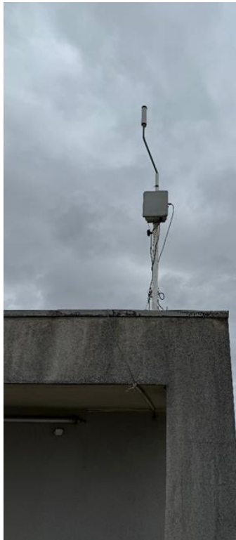
Figura 76 – Sensor de temperatura, instalado na cobertura do edifício
