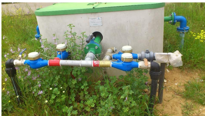
FIGURA 13 – BOCA DE REGA COM QUATRO CONTADORES PARCIAIS
