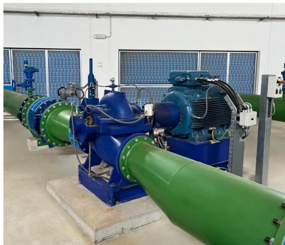
FIGURA 7 – GRUPO ELETROBOMBA AUXILIAR
