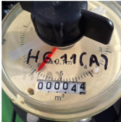
FIGURA 14 – LEITURA OBSERVADA NO CONTADOR
