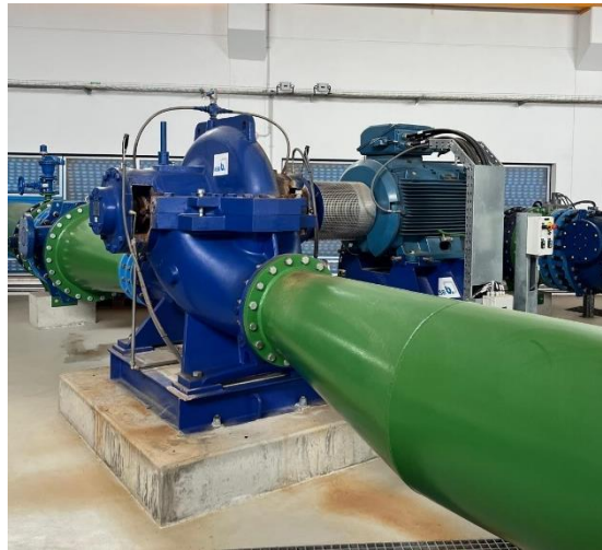
FIGURA 6 – GRUPO ELETROBOMBA PRINCIPAL
