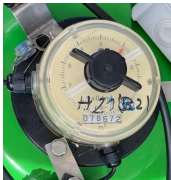
FIGURA 19 – LEITURA OBSERVADA NO CONTADOR
