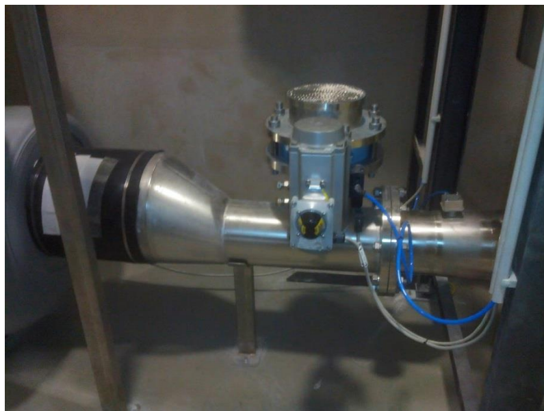
Figura 56 - Subconjunto de saída do reciclone e admissão de ar fresco instalado
