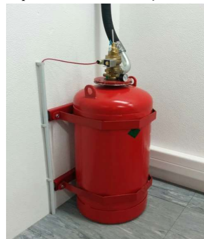
Figura 4 - Reservatório do agente extintor
