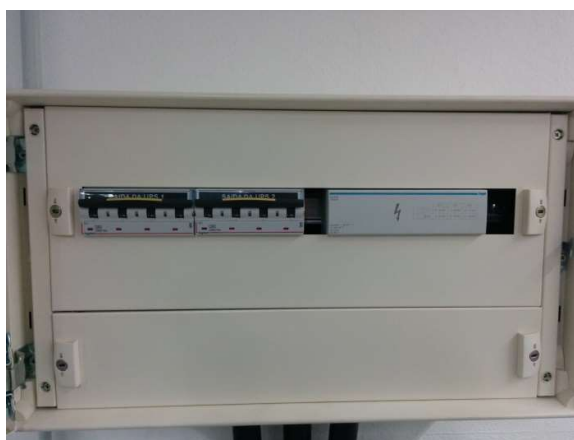
Figura 8- Quadro de Bypass das UPS
