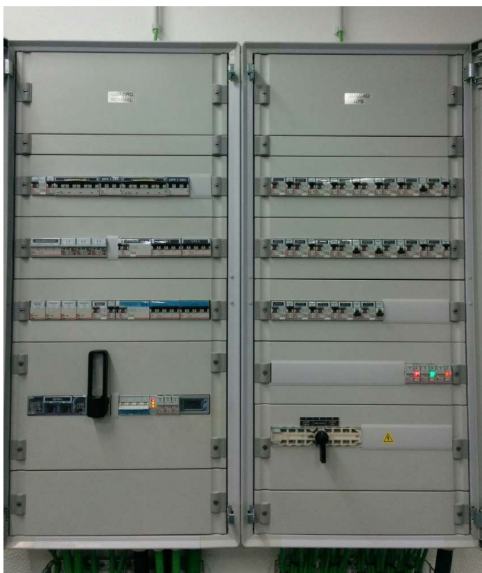
Figura 5 - Quadro elétrico do Data Center do ISEC
