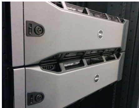
Figura 16 - Unidades de armazenamento instalada
