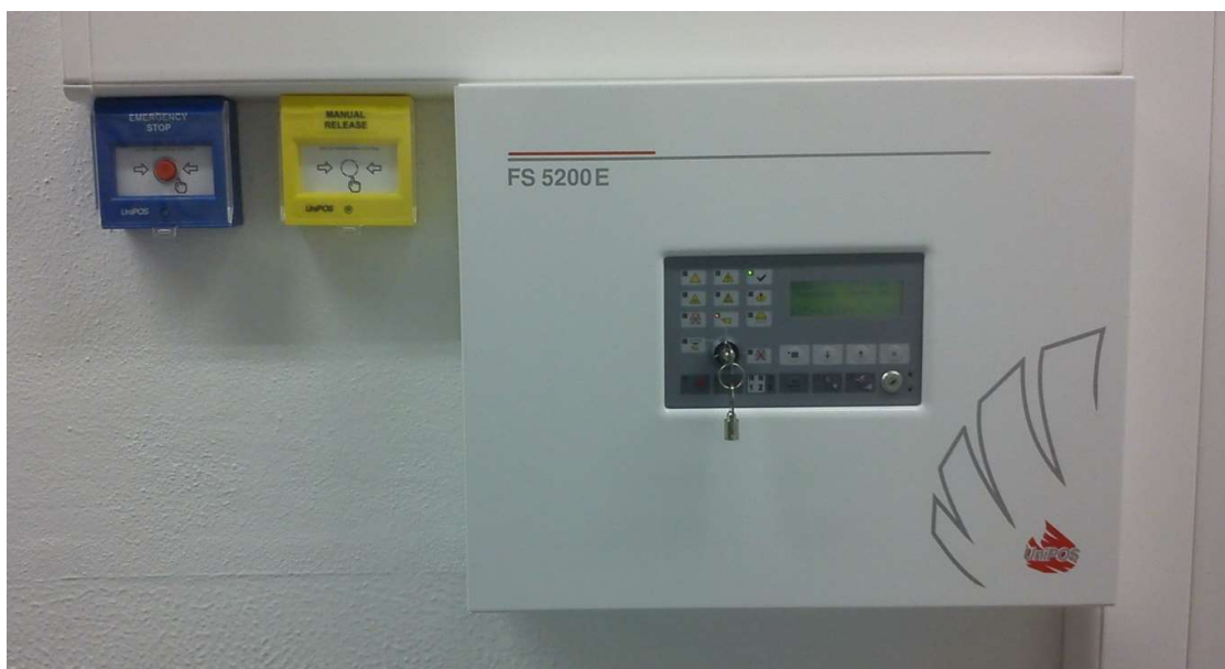
Figura 3 - Central de controlo de incêndios e botões de emergência
