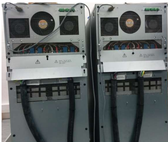
Figura 7 - Pormenor da instalação em paralelo das UPS
