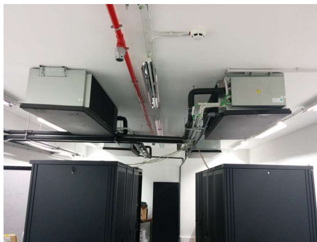
Figura 10- Disposição das unidades de arrefecimento no DC
