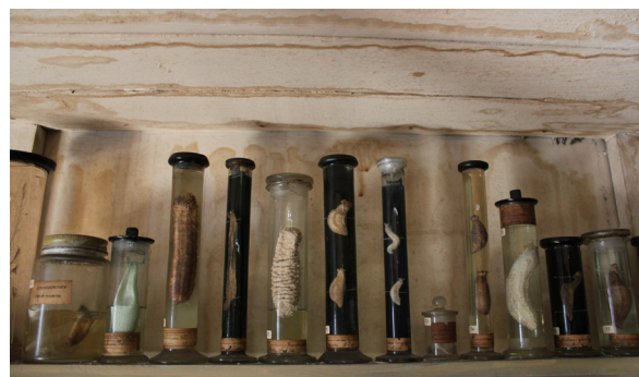
FIG. 2 Marcas das infiltrações e humidade nos armários da reserva do Museu de História Natural da Universidade do Porto.
