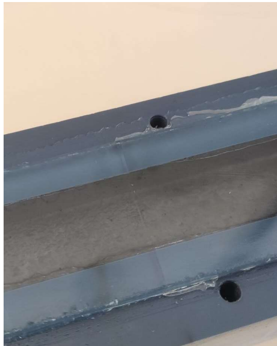
Figura 3.11 – Quebra do vidro de cobertura do canal de escoamento.
