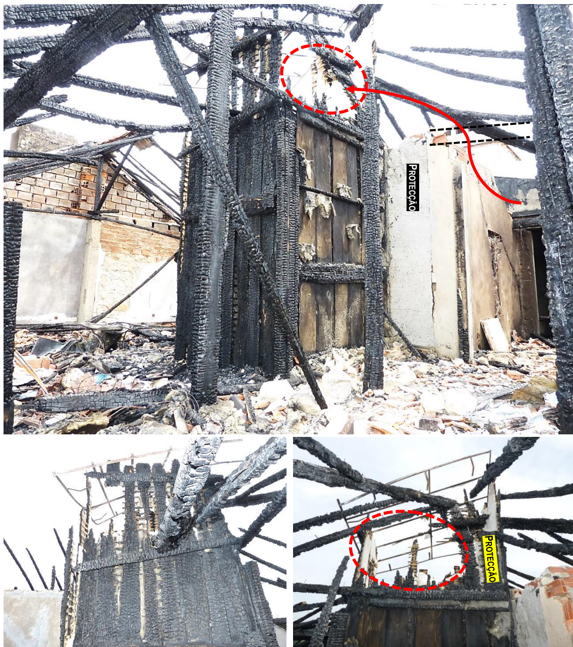
Picture 17 – Na estrutura da caixa de escada onde assentava a clarabóia, contrariamente ao verificado nas faces expostas ao primeiro e segundo pontos de início (vide Fotos 11 e 22) foi identificado numa das faces um dano pontual -círculo a tracejado vermelho- resultante da acção do calor de uma propagação proveniente de um terceiro foco de incêndio -vector a vermelho-, razão pela qual o movimento dos fluídos de ar quente protegeram a zona de canto da parede e da estrutura da caixa de escada. Esse localizava-se do lado oposto dos anteriores na zona entre as fachadas lateral esquerda e a de tardoz.
