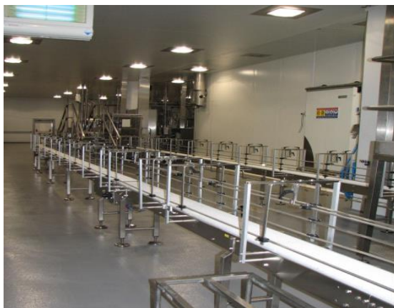
FIGURA 43 EXTERIOR TUNEL FRIGO 2 NA ZONA DE PRODUÇÃO
