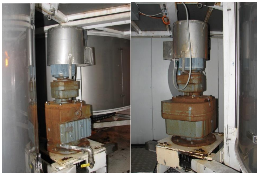
FIGURA 46 MOTO-REDUTORES DA TORRE DE SUBIDA E DA TORRE DE DESCIDA
