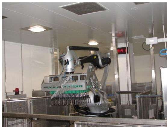
FIGURA 42 ROBOT ENTRADA TÚNEL DE CONGELAÇÃO
