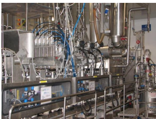
FIGURA 41 VISTA GERAL DA BIG-DRUM
