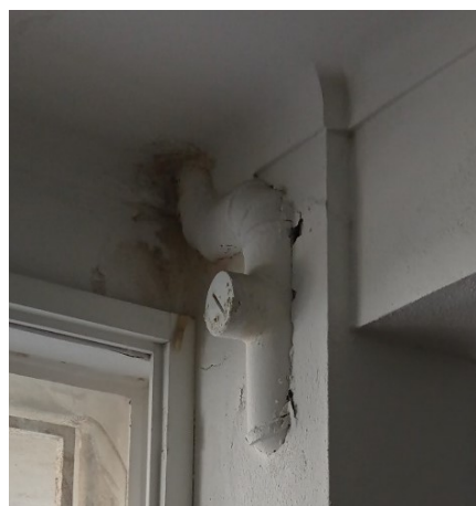
Figura 38 – Tubo de escoamento de água saliente.
