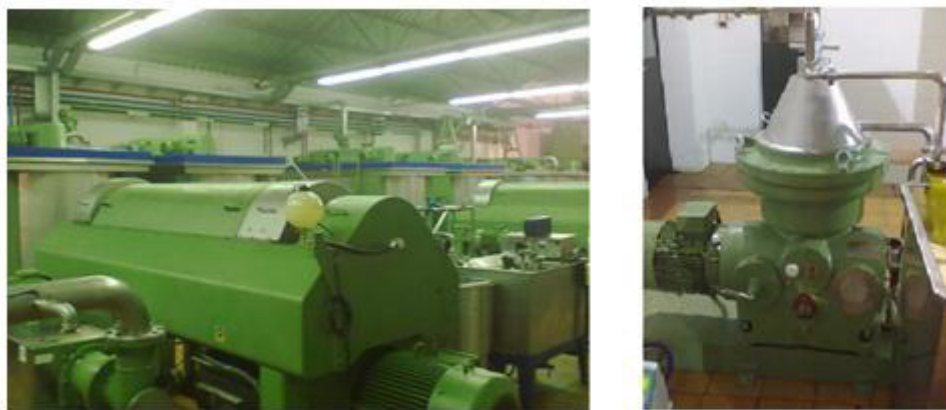
FIGURA 9. Centrifugas horizontais, vista geral (à esquerda) e centrífuga vertical (à direita) (foto L. Serrano, 2013)
