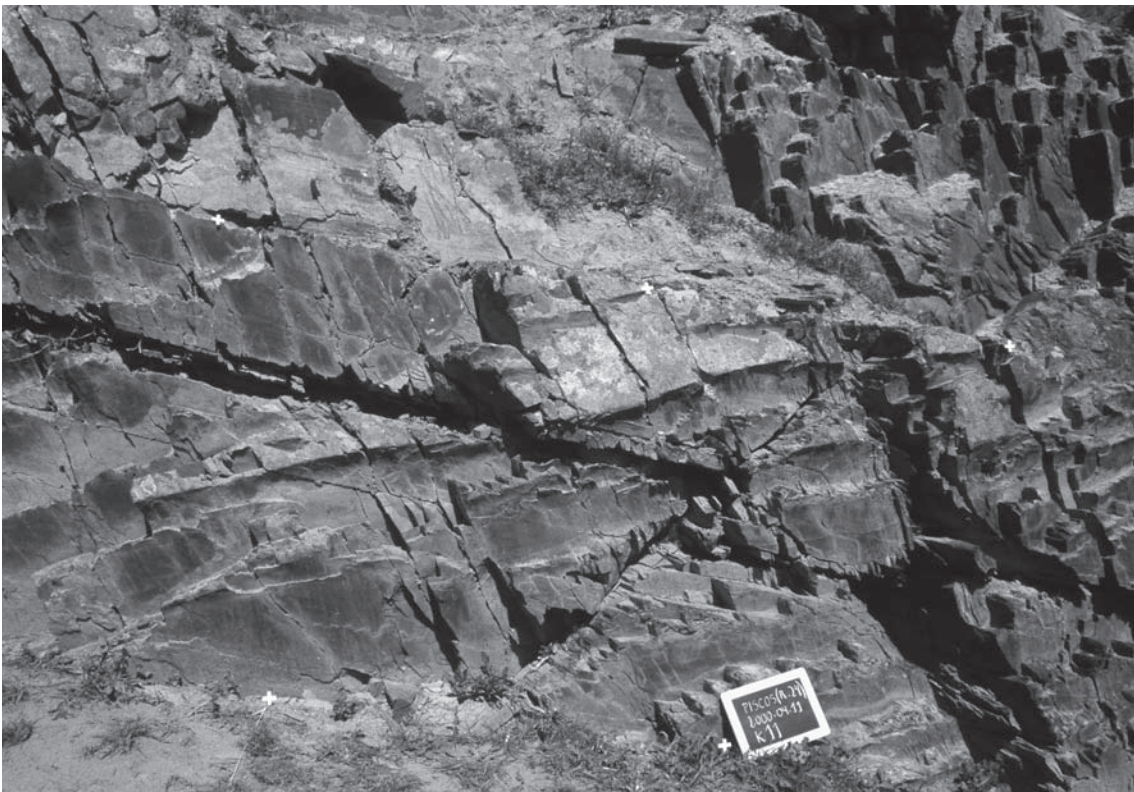
FIG. 7.3-27 – Ribeira de Piscos. Roche 24. Effondrement des parois rocheuses.
