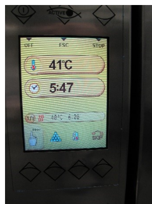
Figura 32.2: Painel de controlo das condições de processo da secagem no forno
