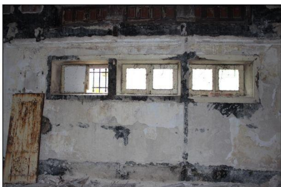
27. Zona da caldeira de aquecimento
