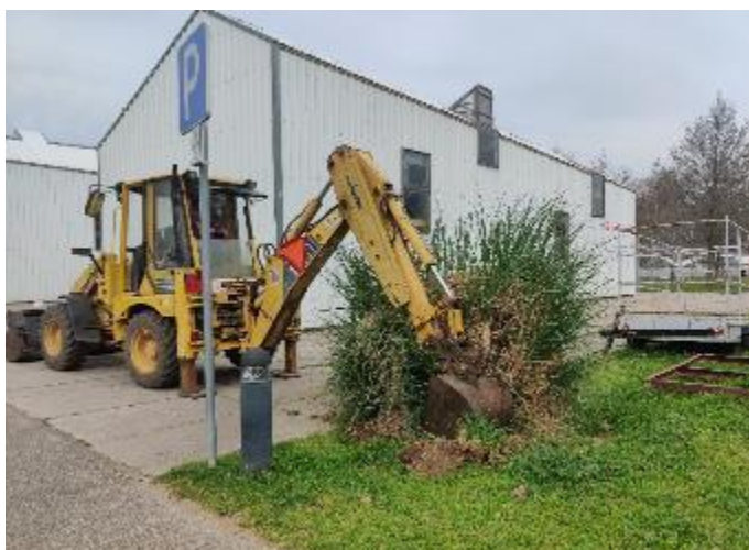
Figura 13 - Remoção de Cortaderia selloana de grandes dimensões no parque verde, junto à margem esquerda do rio Mondego.
