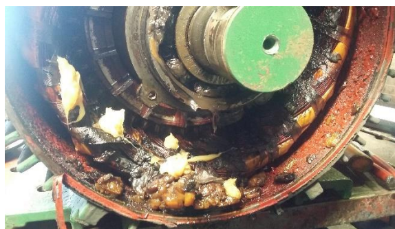
Figura 2. 9 - Verificação de Excesso de Lubrificação após abertura do 'MI'
