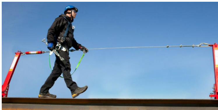
Figura 12 - Sistema de linha de vida horizontal provisória
