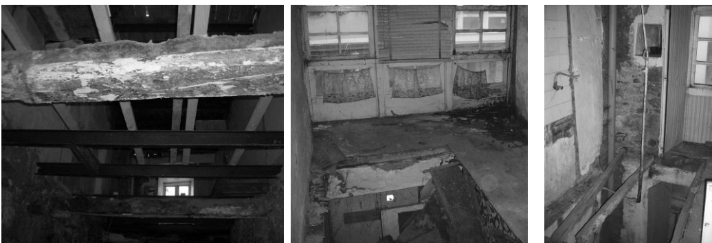
60. Conjunto de Imágenes del Estado de los Forjados del Edificio 29
