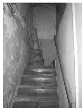
61. Conjunto de Imágenes del Estado de las Escaleras del Edificio 29
