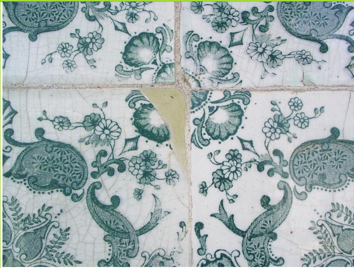
Amarelecimento da resina de preenchimento
