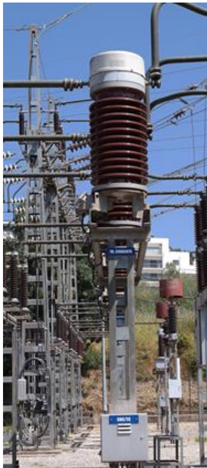
Figura 3.5 - Transformador de Intensidade de Corrente.
