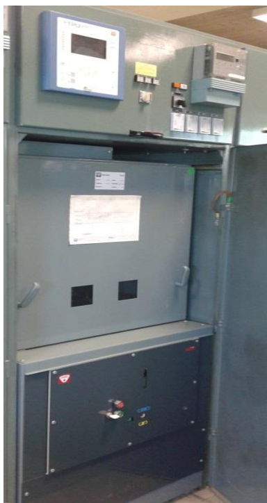
Figura 4.3 - Painel de Linha e Média Tensão.
