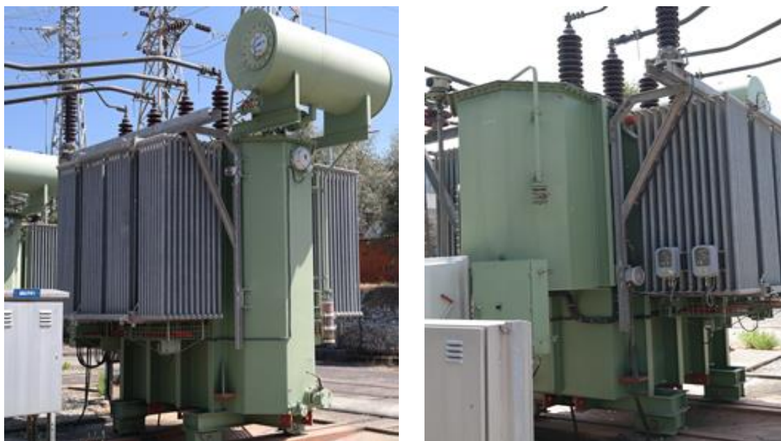
Figura 3.9 - Transformador de Potência
