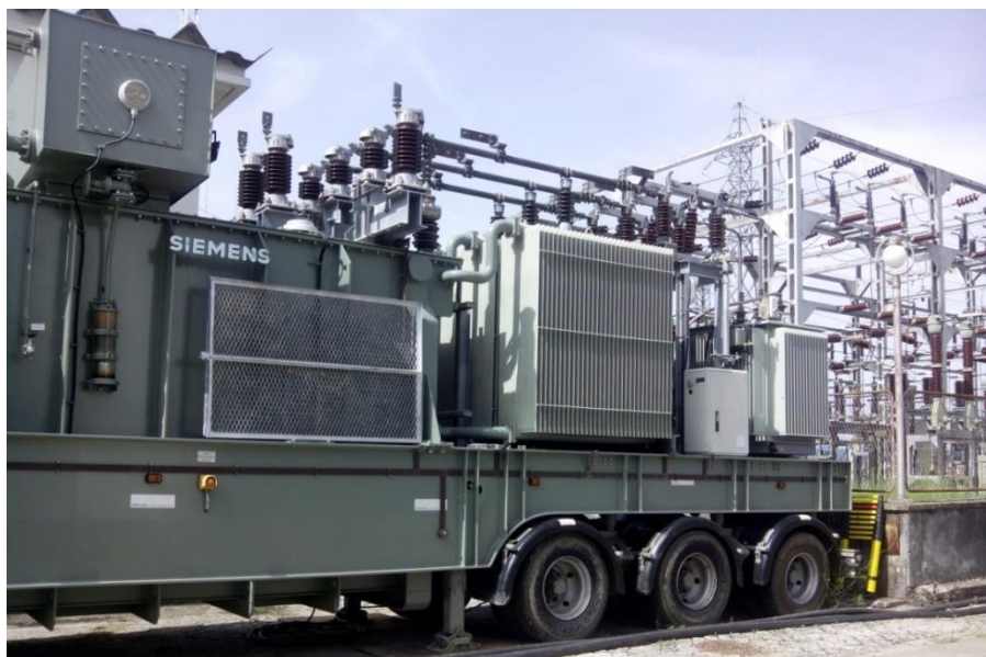
Figura 4.2 – Transformador de Potência móvel.
