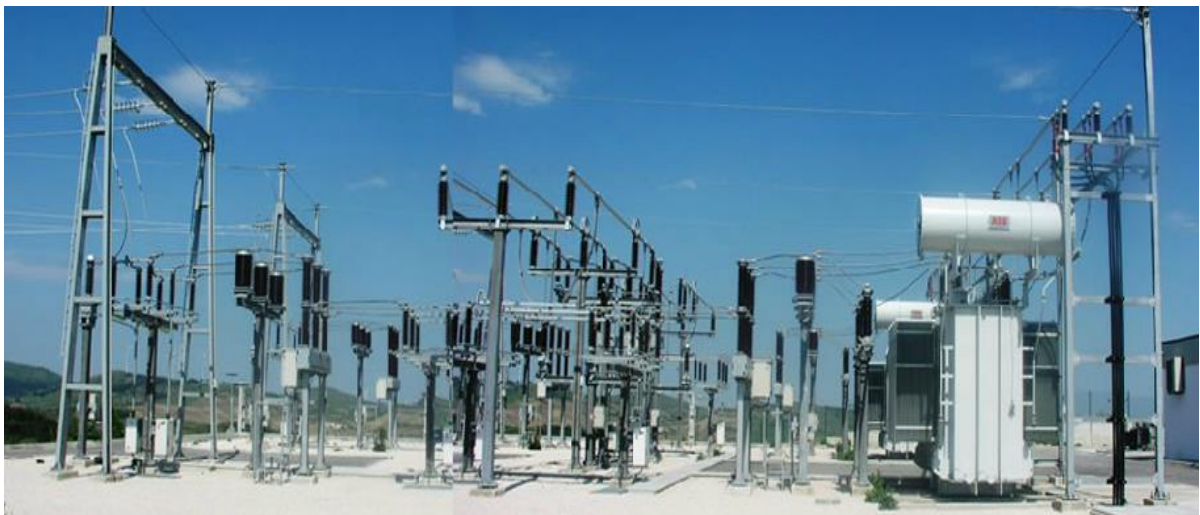
Figura 3.1 – Subestação tipo de distribuição (EDP Distribuição, 2013).
