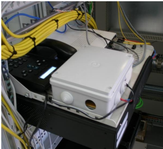
Figura 6.17 - Reset Remoto do Repetidor de Ponte Sôr.
