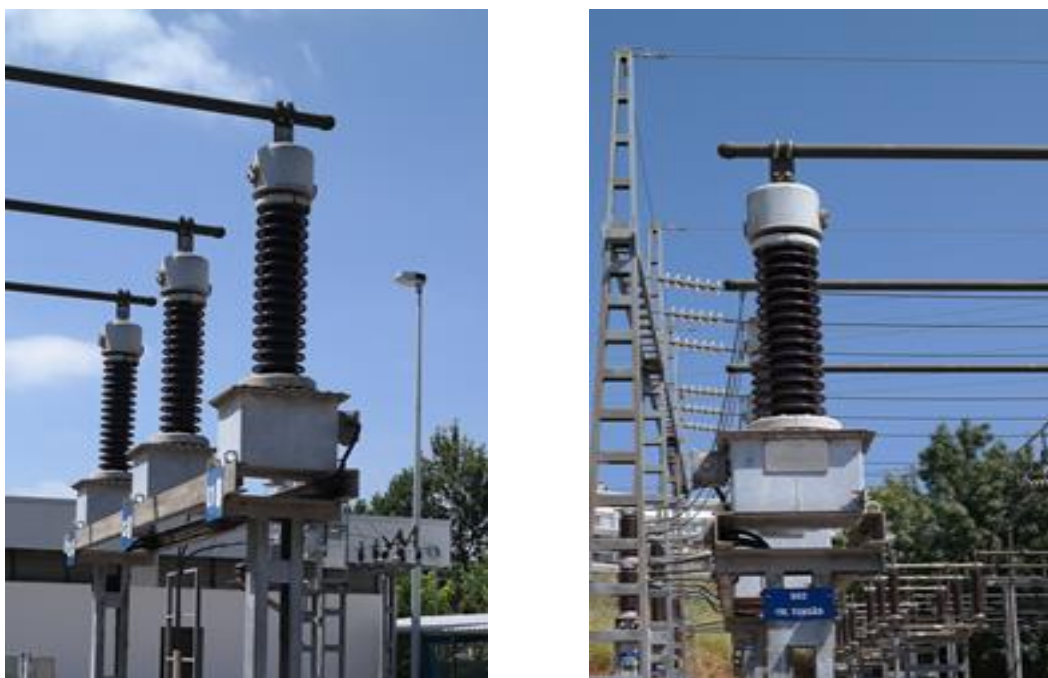
Figura 3.3 – Transformador de Tensão.
