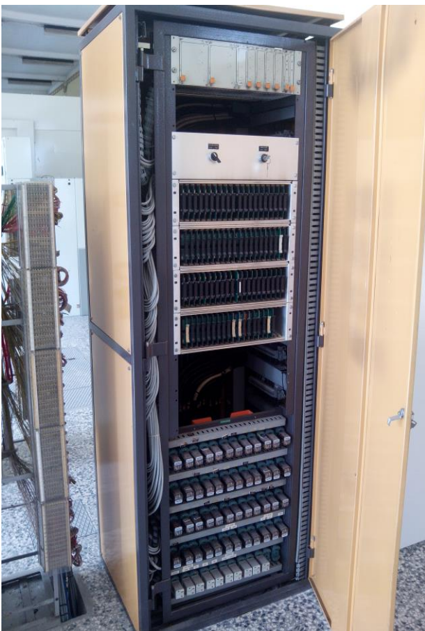
Figura 3.26 - Armário de Isolamento Galvânico.
