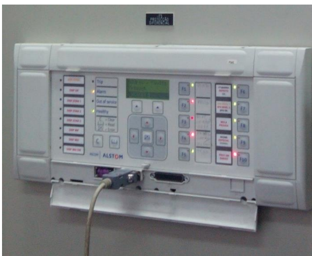
Figura 4.6 – Proteção Micom P545 que foi ensaiada.
