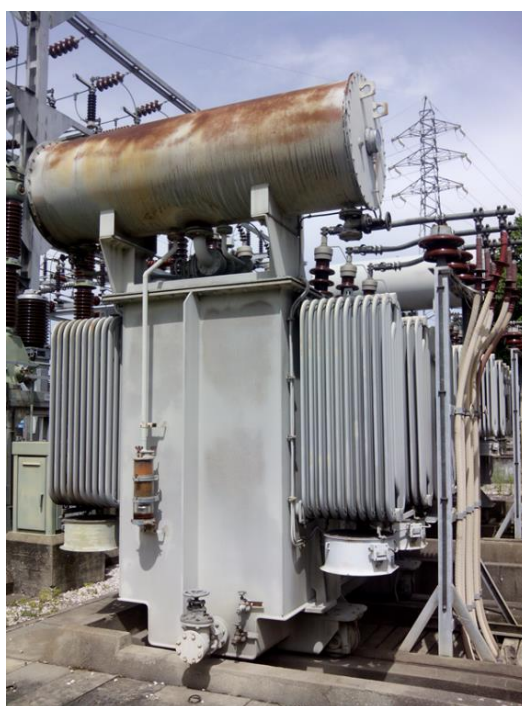
Figura 4.1 – Transformador de Potência da Subestação da Lousã.
