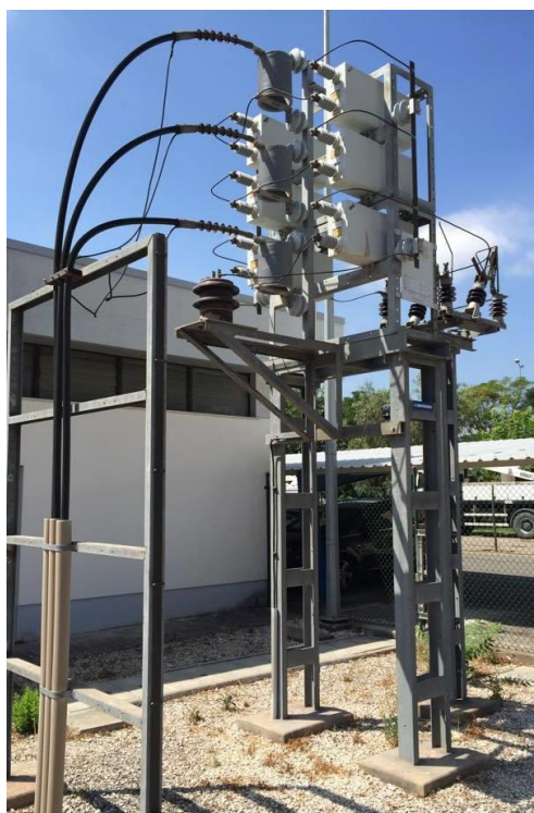
Figura 3.11 - Baterias de Condensadores.
