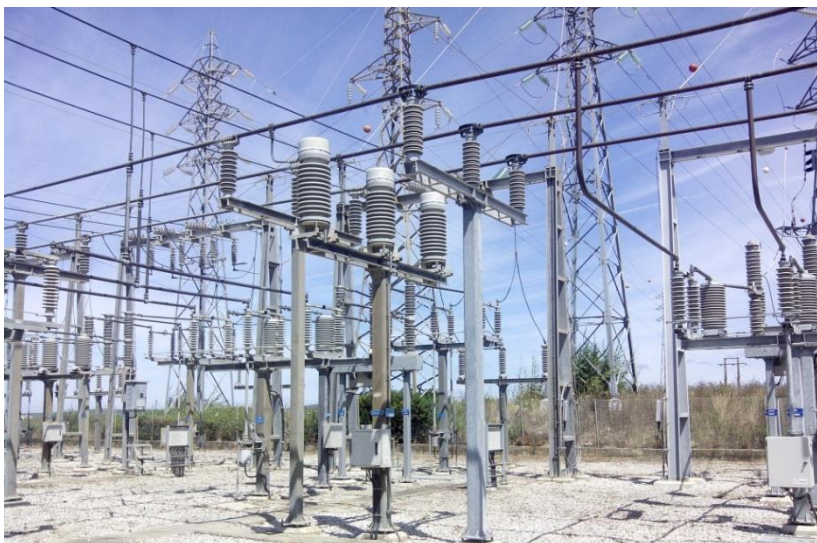
Figura 3.32 – Aparelhagem da subestação.
