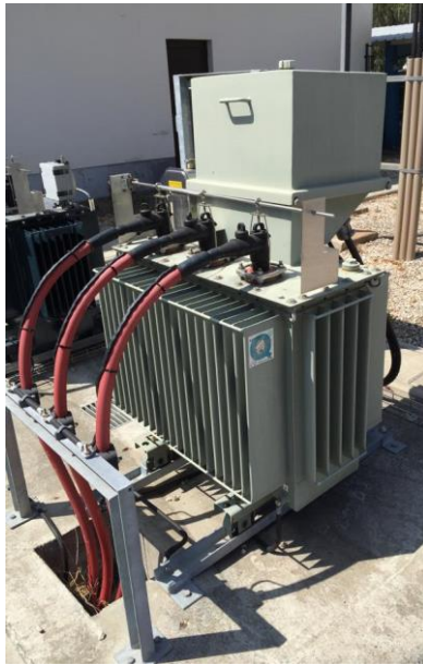
Figura 3.13 - Transformador de Serviços Auxiliares.
