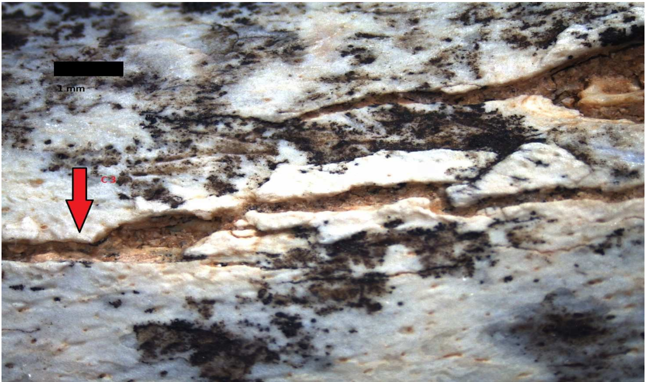
Fig. 14: Fessurazione di grado C3.
