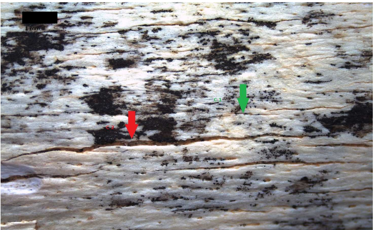
Fig. 13: Fessurazione di grado C1 (verde); fessurazione di grado C2 (rosso).
