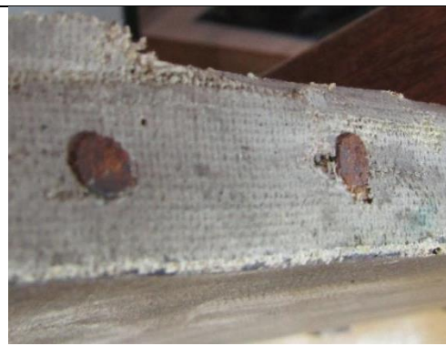
Figura 44: Oxidação dos elementos metálicos e do suporte
