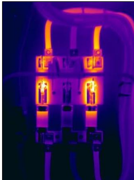
Figura 29 - Energia térmica a radiar de um fusível. [79]
