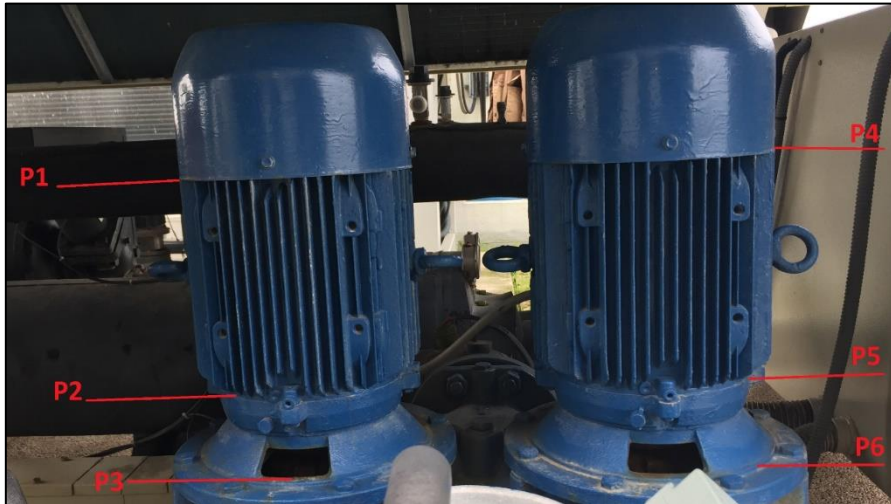
Figura 40 – Motor de acionamento da Bomba 2 e Bomba 1
