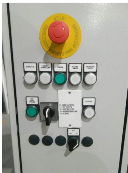
Figura 3.26: Botoneira de controlo implementada na lateral do quadro elétrico [1].
