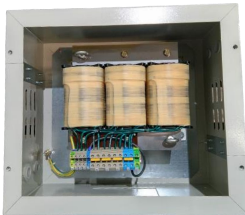
Figura 3.13: Transformador trifásico do quadro controlador de eixos.
