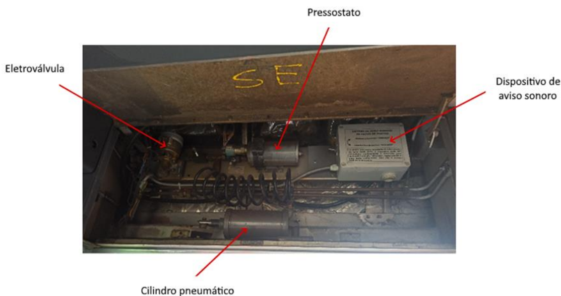
Figura 4.3 – Painel de acesso ao sistema de abertura e fecho de porta
