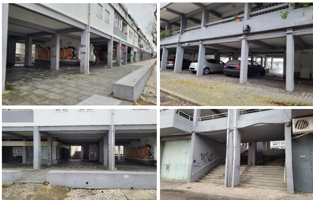
Figura n.º7 – Bairro branco (Monte de Caparica) com uma construção que dificulta a intervenção policial
