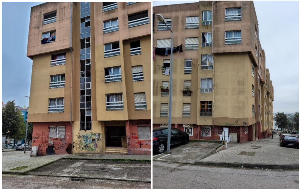
Figura n.º12 – Sinais de vandalismo bairro Asilo 28 de maio
